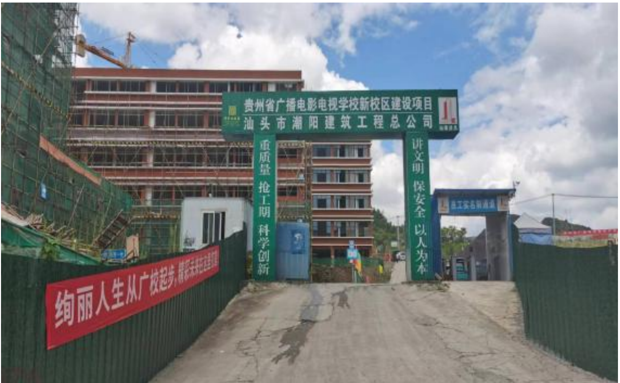
图 4-9 地块周边西南侧贵州省广播电影电视学校新校区现场踏勘图
